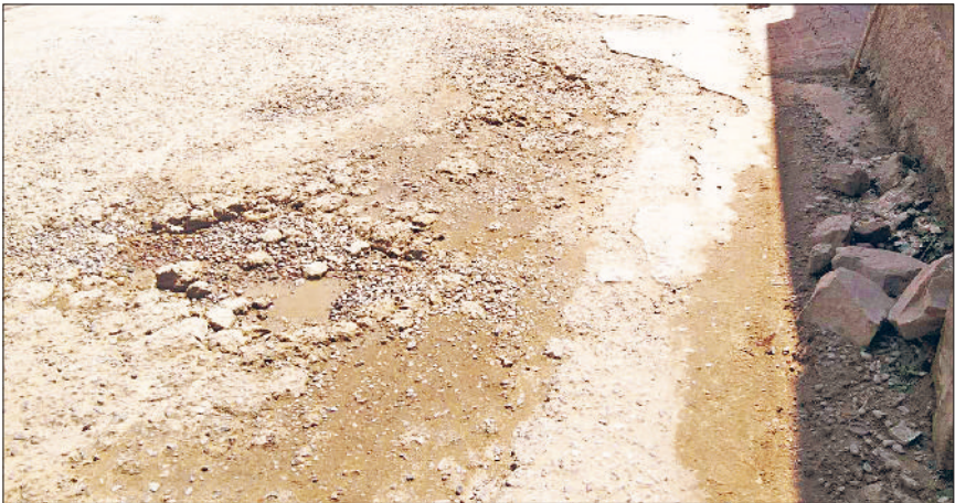
महेंद्रगढ़। जर्जर अवस्था में सड़क।
